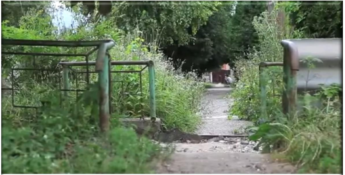
Бетонные ступеньки лестницы тротуара, куда врезались санки
